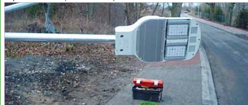
Uszkodzona lampa na trasie Włynkowo-Włynkówko.
